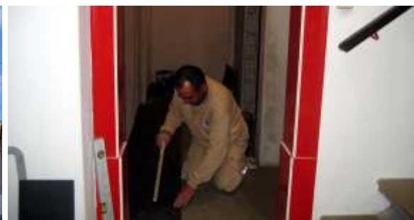
instalações sanitárias no edifício dos Paços do Concelho
