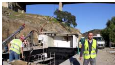
Antiga Etar de Mértola Futura Estação de Transferência
